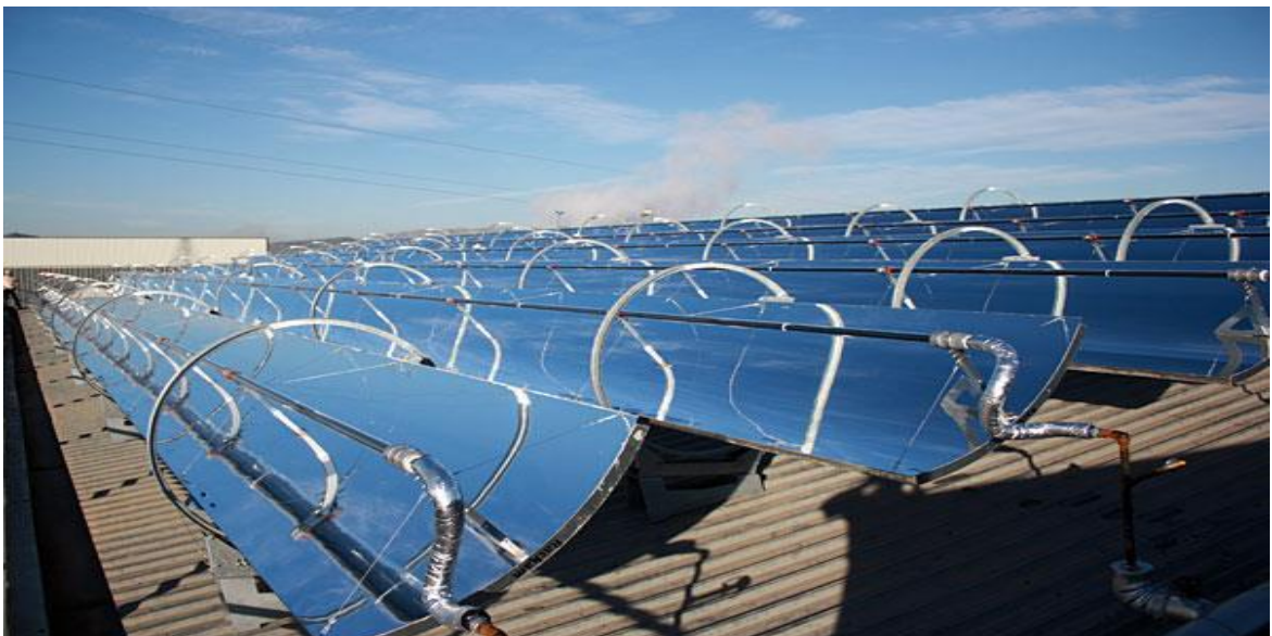
Figure II-7 : Centrale solaire cylindro-parabolique.
