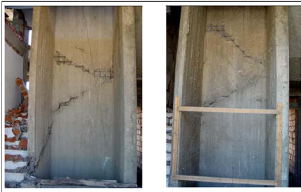
Figure I.17 : La présence des voiles en béton armé au droit de la cage d'ascenseur à certainement sauvé le bâtiment de l'effondrement (Davidovici 2003).
