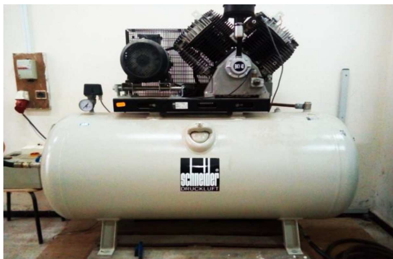
Figure III.16: Compresseur à air.
