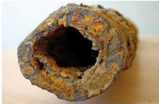
Figure I.2 : Vieillessement des canalisations [IKHLEF & HALICHE, 2018].
