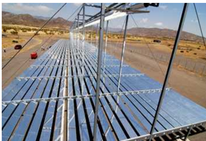
Figure I. 09 : Les centrales solaires à miroir de Fresnel[9].
