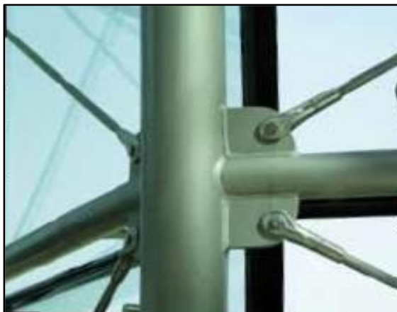
Fig. 135 : vérification de la prétention Source : tirant. PDF
