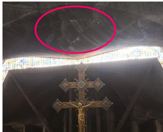
Fig 39 : Infiltrations d'eau à l'intérieur de l'église
