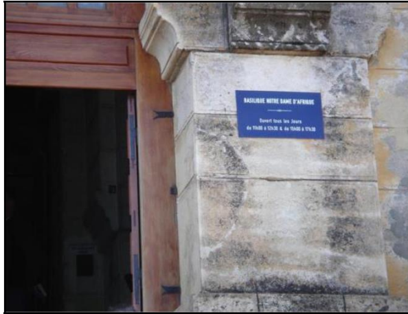
Fig 12 : Etat de la pierre de la cathédral avant la restauration
