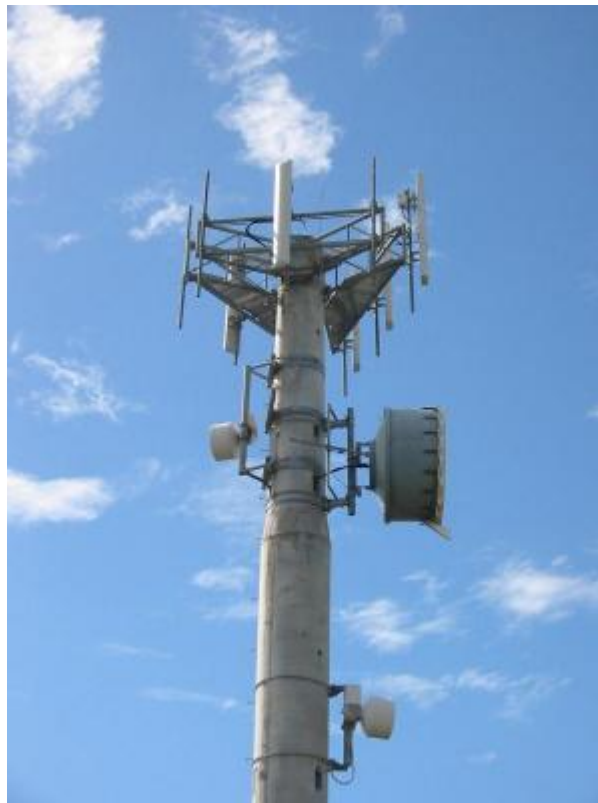
Figure I.2 : Exemple d'antennes GSM.
