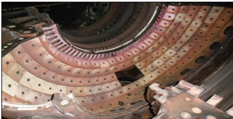
Figure .I.6 : Vue interne de la chambre de combustion
