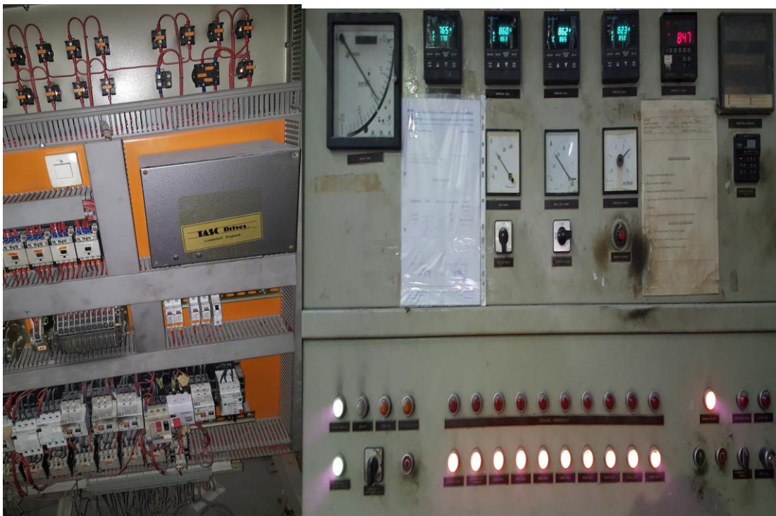
Figure1.2 vue de face et arrière de l'armoire principale
