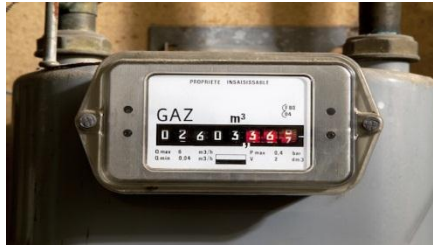
Figure1.26. Compteur à gaz
