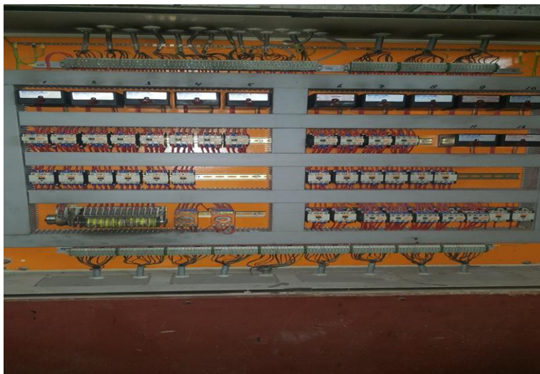
Figure 1.14 Armoire électrique secondaire
