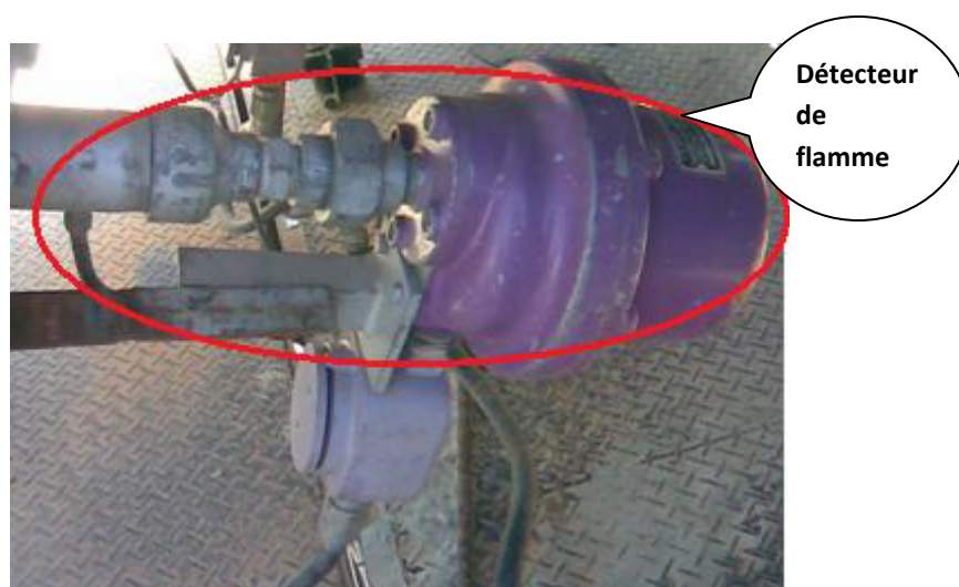
Fig II.4 : Détecteur de flamme
