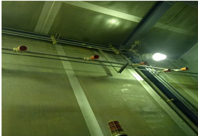
Figure I.7 : les buses de décharge CO2 zone A
