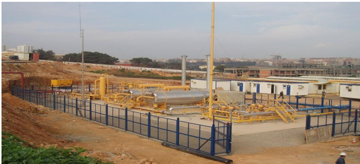
Figure III.3 : poste gaz de la centrale électrique
