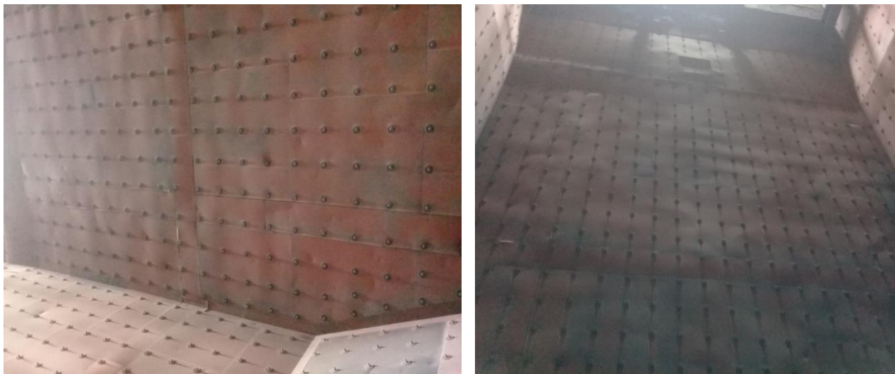
Figure IV.15 : Vue effectuée sur les parois d'échappement
