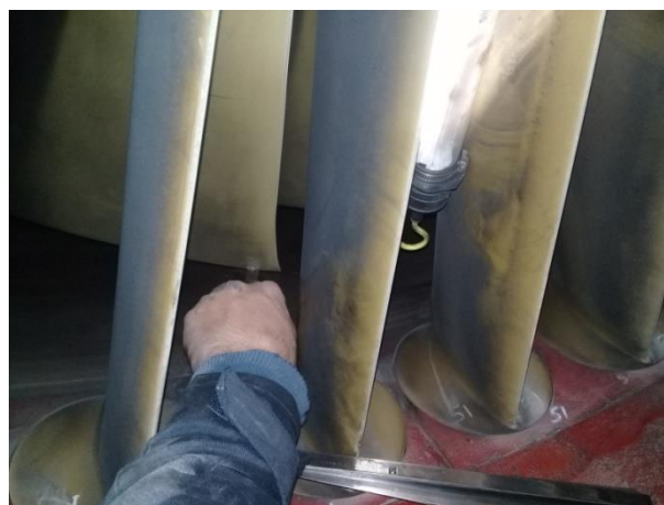
Figure IV.18 : Inspection visuelle effectuée sur conduite d'admission (avant et après le nettoyage)
