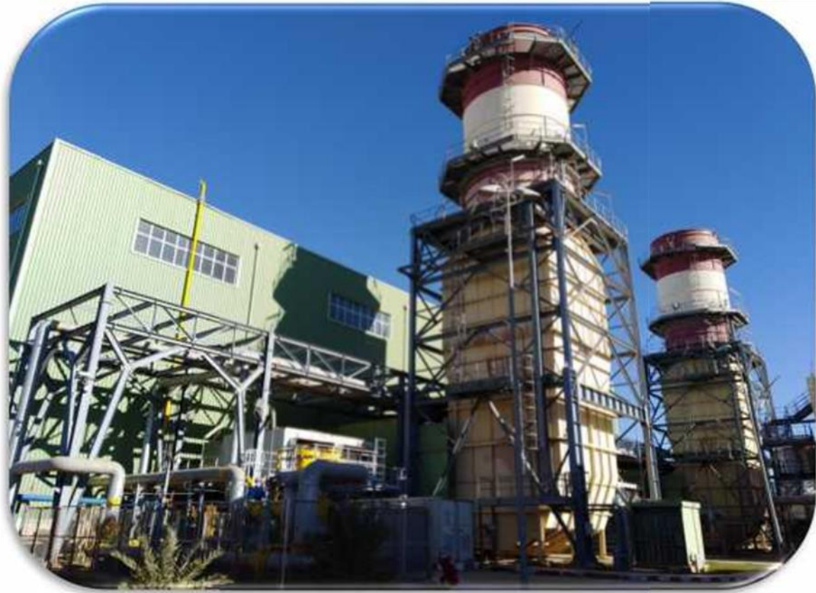
Figure I.1 : vue sur un groupe de 215MW ENSALDO
