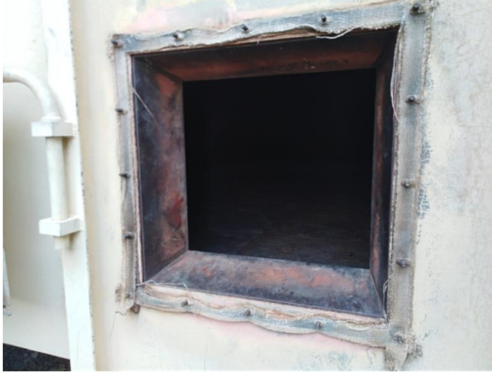
Figure IV.14 : Vue sur le joint de la trappe d'échappement
