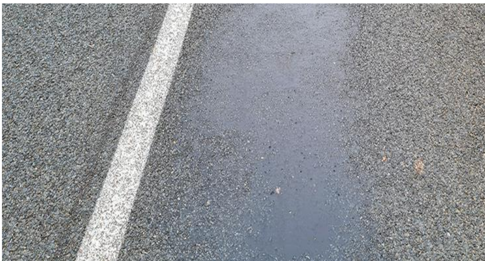
Figure I.18. Le Ressuage d'une chaussée (Dal Pos, 2020).
