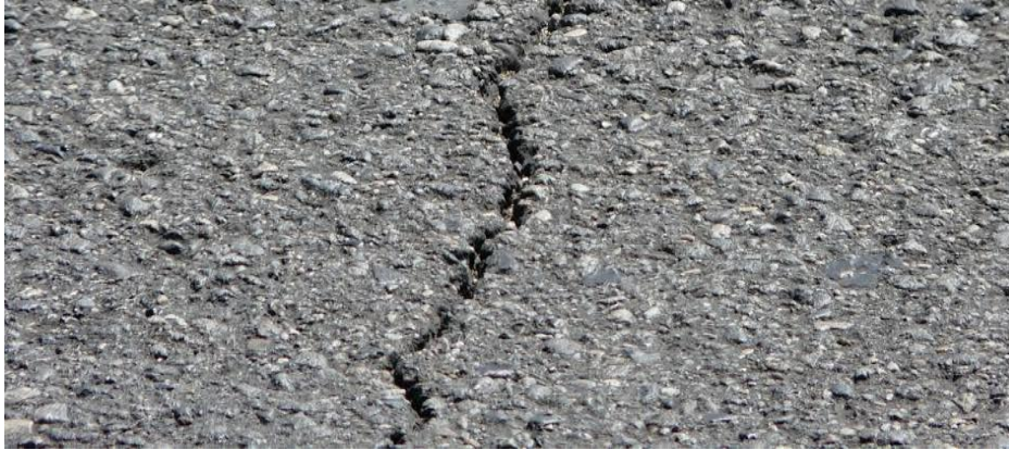
Figure I.14. Fissuration par fatigue.
