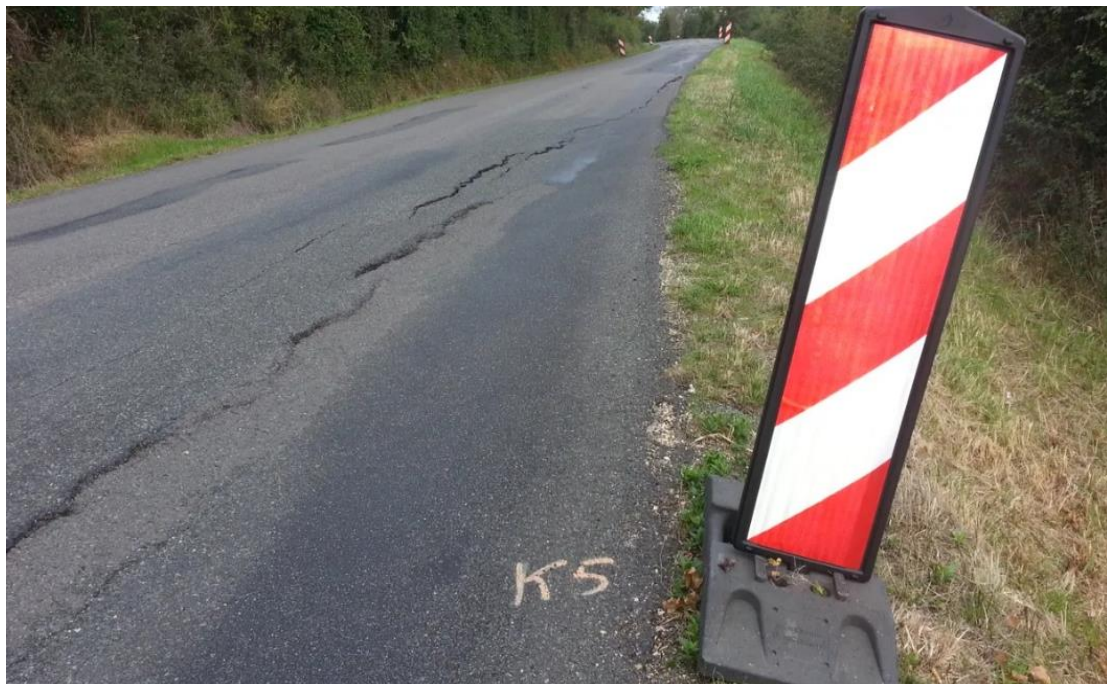
Figure I.11. Fissurations longitudinales en France.
