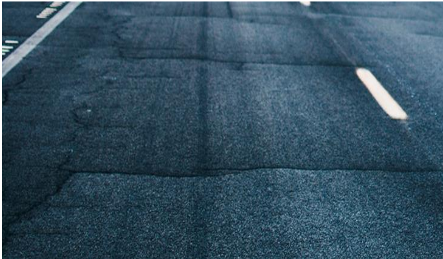
Figure I.12. Fissures transversales de la chaussée.
