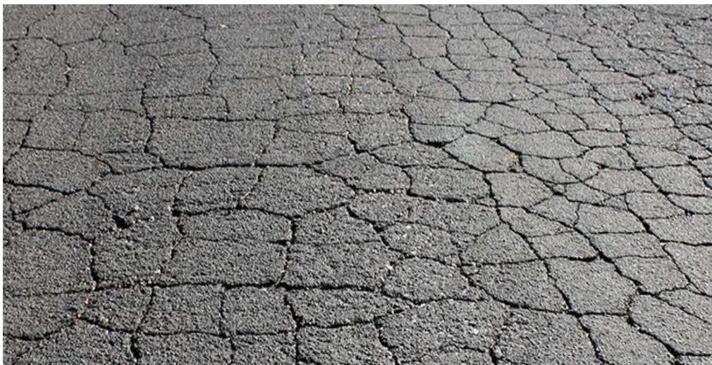
Figure I.13. Faïençage d'une chaussée.
