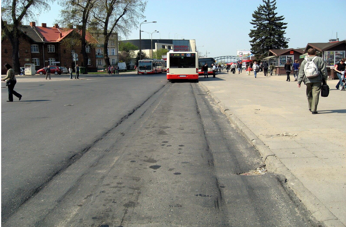
Figure I.8. Orniérage d'une route (Sienicki, 2011).
