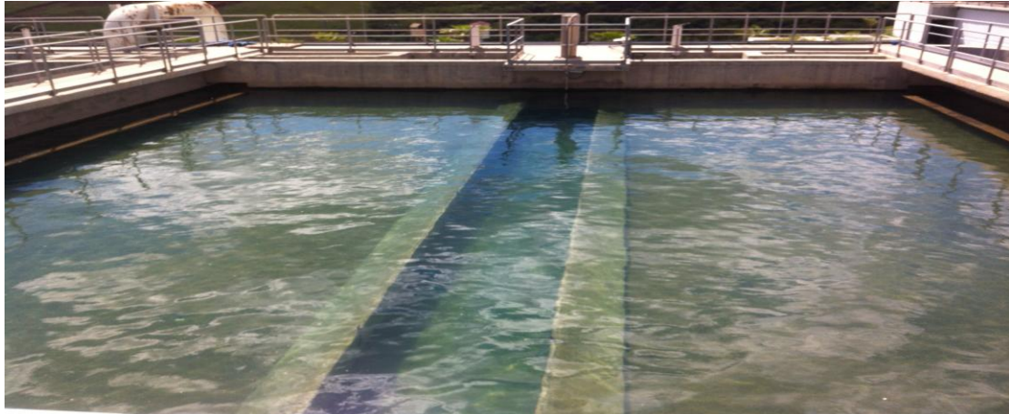
Figure 07 : Filtres de la station
