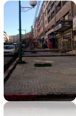
FIGURE 70: DEGRADATION DE L'ETAT DES TROTTOIRS. SOURCE : AUTEUR.
