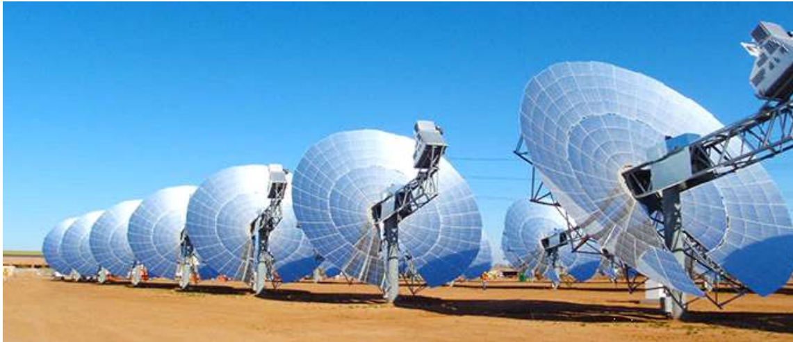
Figure II.04 : Centrale solaire utilisant des concentrateurs paraboliques (Maricopa, Arizona, États-Unis).
