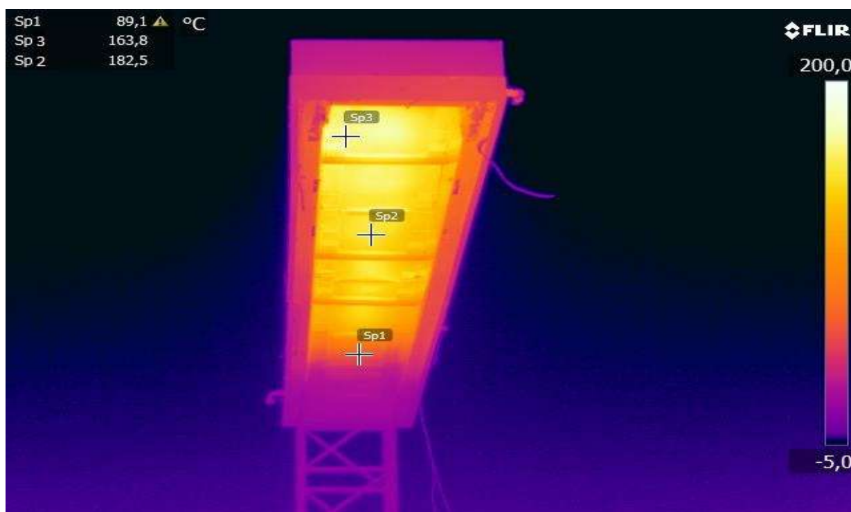
Figure V.23 : Niveau des températures enregistrées à l'aide de la camera thermique.
