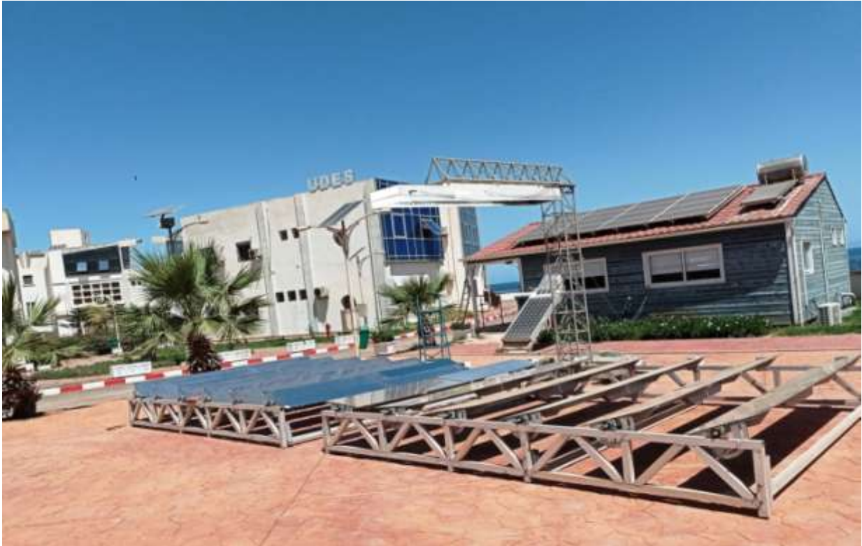
Figure V.09 : l'état final de l'installation obtenue.
