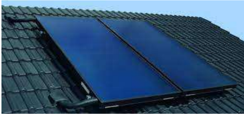
Figure I.08 : Panneaux solaire thermique.
