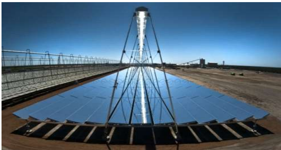
Figure II.09 : Centrale solaire à miroirs de Fresnel.
