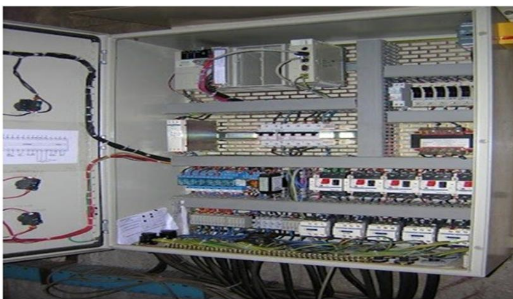
Figure II.1 – Exemple d'une armoire de commande
