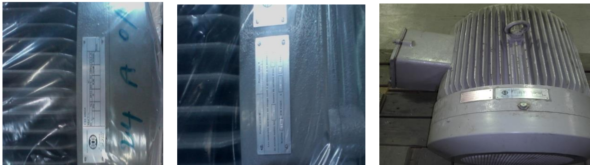
Fig.III.5 : Plaque signalétique et graissage sur le moteur.
