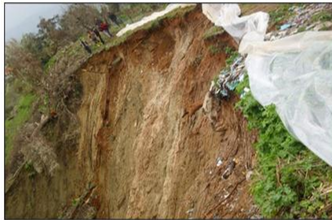
Figure II.4: Glissement rotationnel de Tala-Tegana Tizi-Ouzou, 2012.
