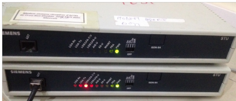
Figure 3.9 – Raccordement des deux modems SIEMENS STU
