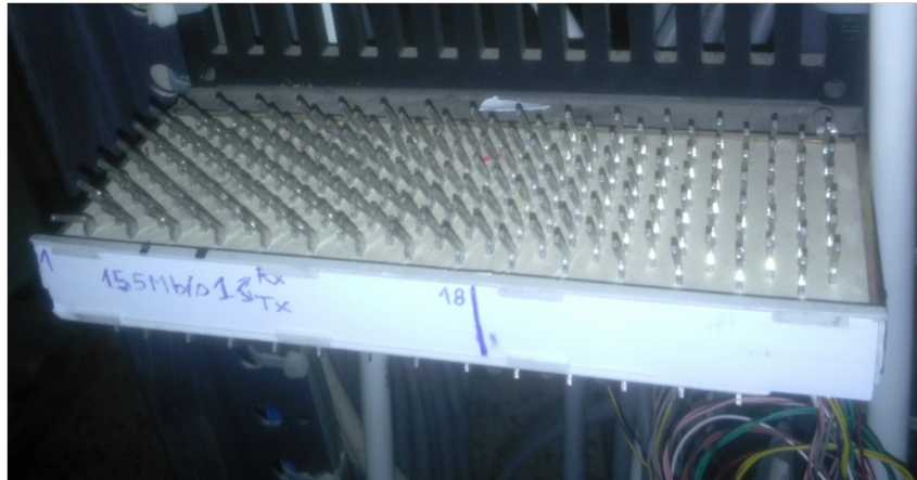
Figure 3.7 – une règlette électrique
