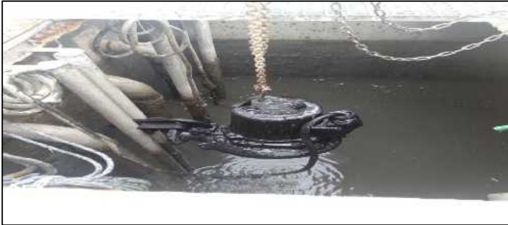
Figure 06 : Poste de relevage.
