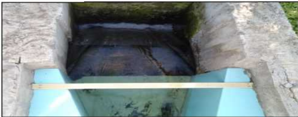
Figure15: Canal de sortie des eaux épurées.
