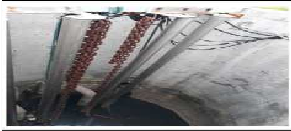
Figure14: Poste toutes eaux
