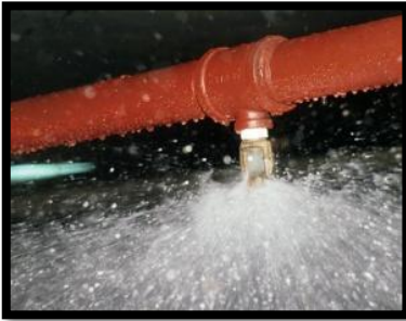
Figure140 : Sprinklers au faux plafond pour la propagation de l'eau en cas d'incendie
