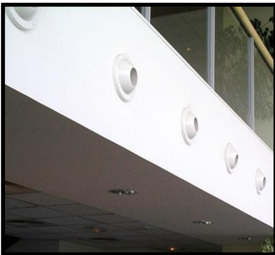
Figure 143 : Bouche de soufflage
