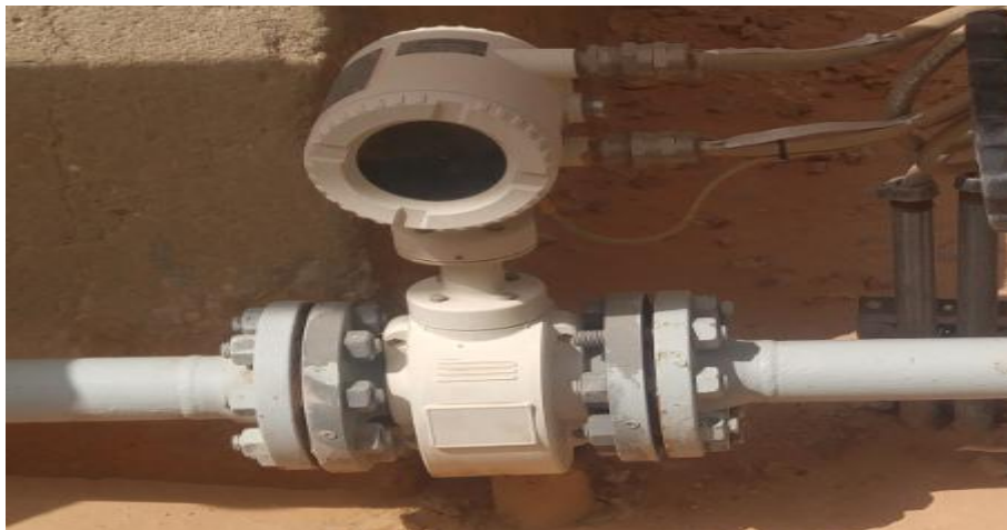
Figure 3.14 : transmetteur de débit
