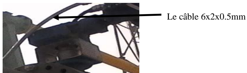
Figure 4.10 : câbles des vannes
