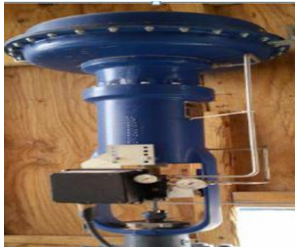
Figure 3.17 : Vanne de régulation de niveau
