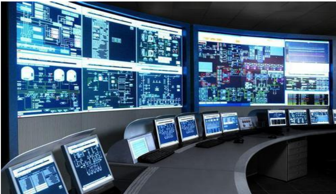
Figure 1.6: Salle de contrôle d'une station
