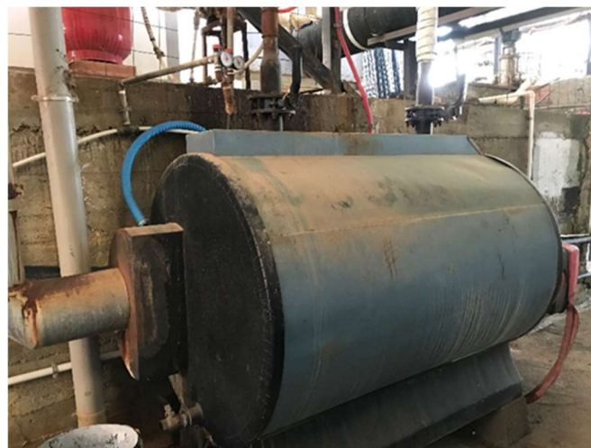
Figure N°16 : La chaudière (photo originale).
