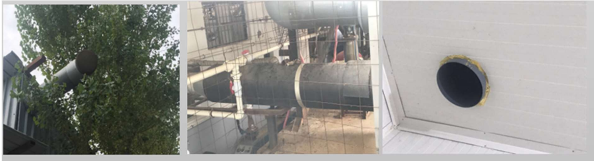
Figure N°15 : le traitement d'air (photo originale)
