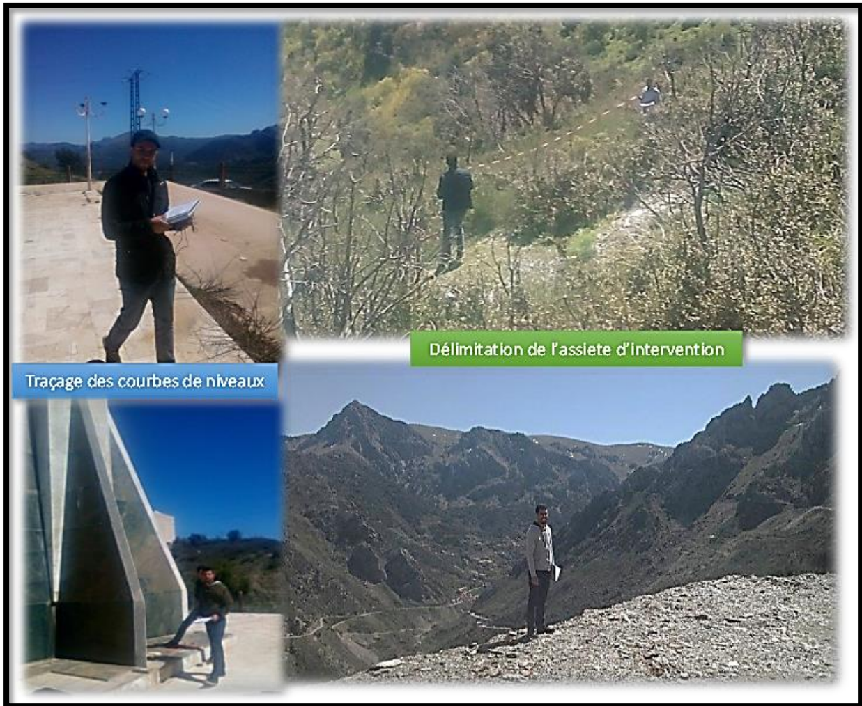
Fig 13: Photos prises sur le site lors de l'élaboration du levé topographique et des limites de l'assiette d'intervention
