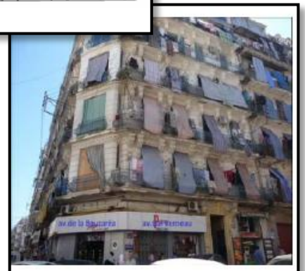
Figure 34 : bâtiment en état dégradé. Source : mémoire fin d'étude L'EPAU 2018
