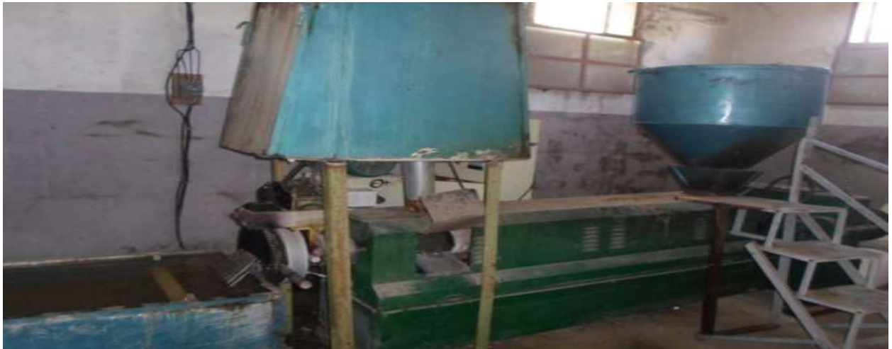
Extrusion de la matière broyée
