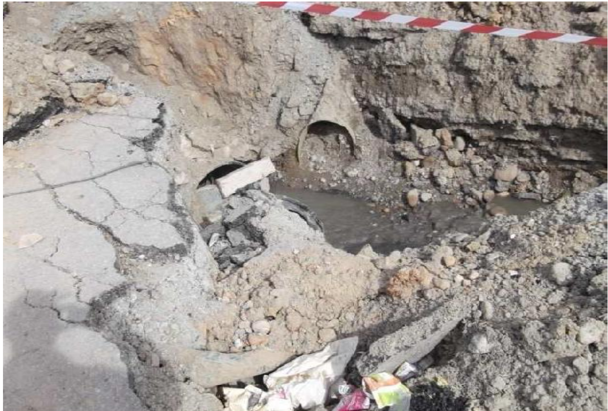
Figure n°4.II : réseau d'assainissement endommagé par le glissement.
