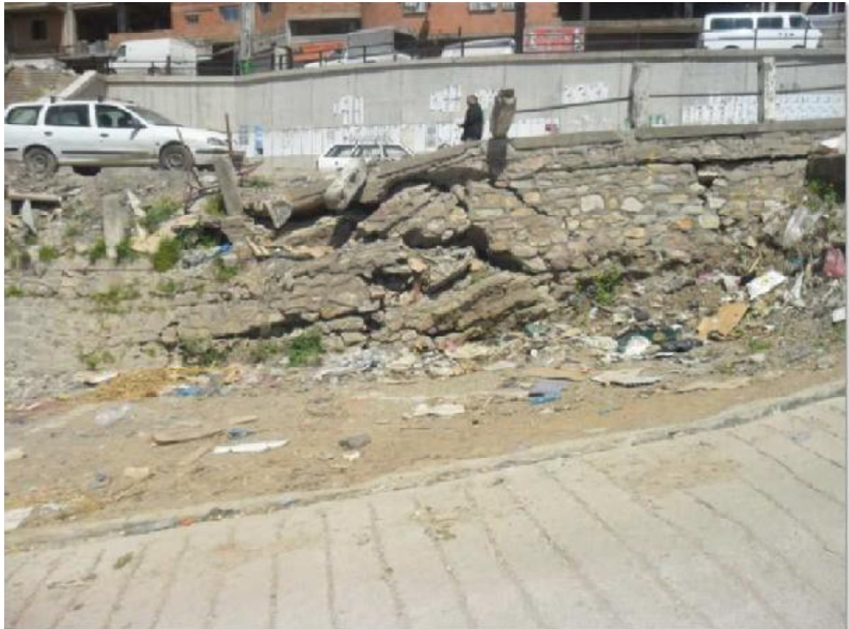
Figure n°7.II : Ruine d'un mur en pierre.
