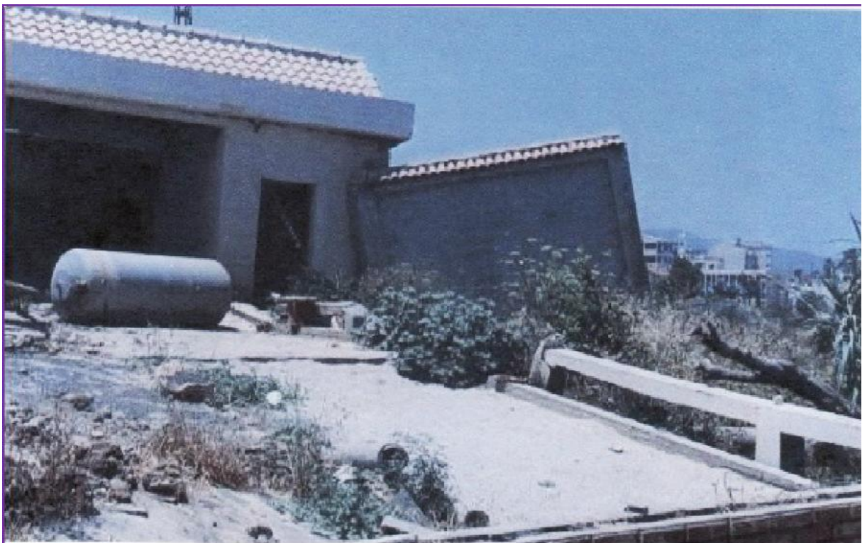
Figure n°8.II : Les loupes de glissements sur site.
