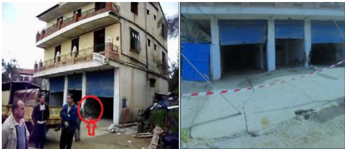
Figure n°3.II : Maison endommagée par le glissement.
