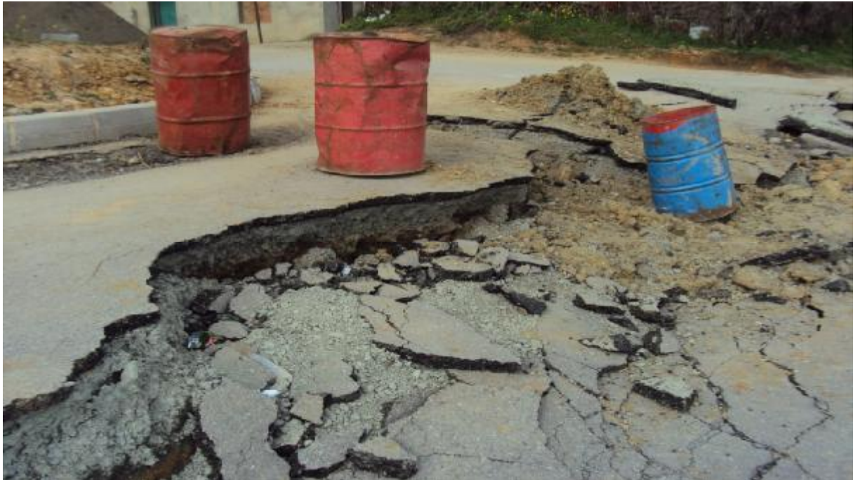
Figure n°1.II : Affaissement d'une chaussée (route coupée).
