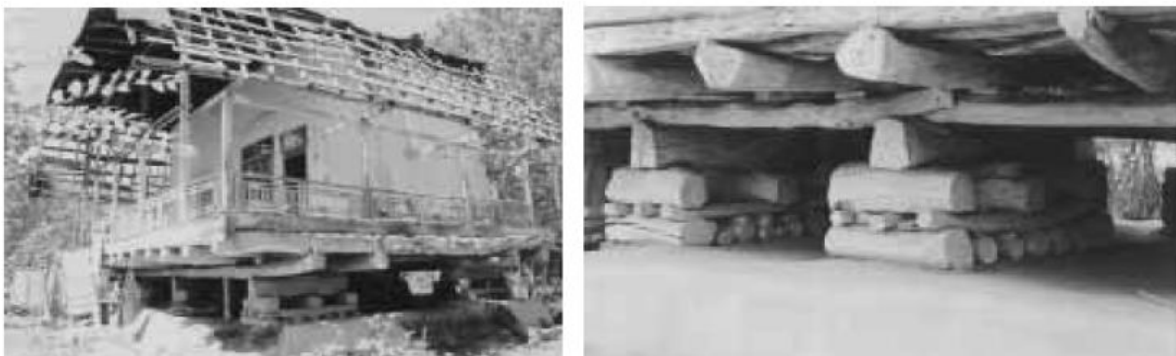
Figure I.3 : Morceaux de bois installés entre la base et le palier des maisons en Iran [9].
