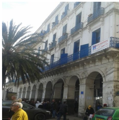
Fig.80: Construction en mauvais état ( Immeuble haussmannien ) Source: Auteur
