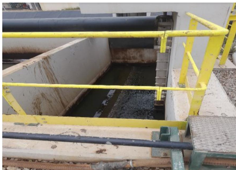
Fig.3.7. Point de prélèvement /Sortie Bassin d'observation 850-CC-019 (Sortie ETP)
