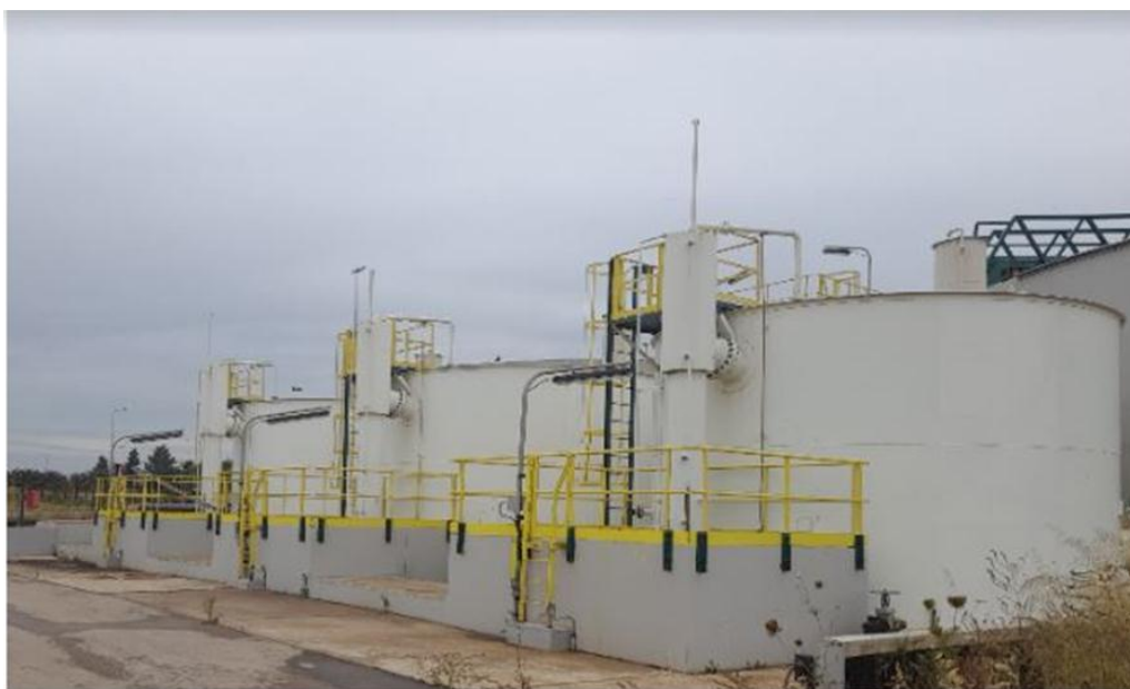
Fig.3.6. Filtres à sable (Traitement tertiaire)
