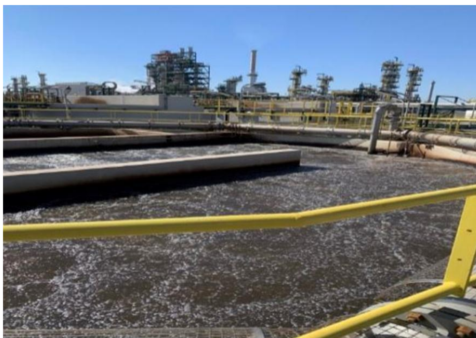
Fig.3.4. Bassin biologique (traitement biologique)
