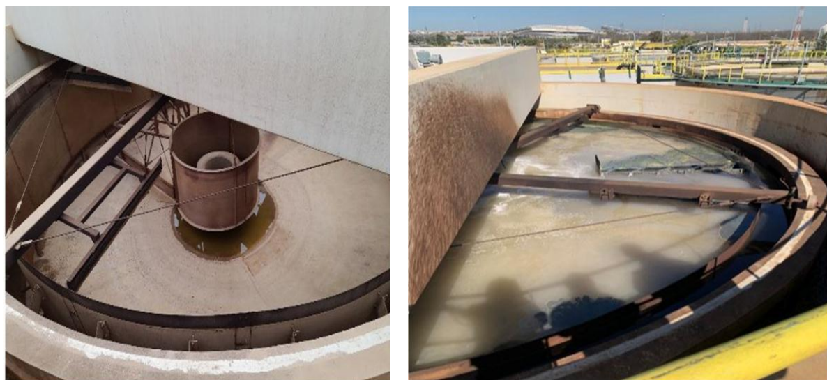
Fig.3.3. L'unité de flottation par l'air dissout + coagulation /floculation (traitement chimique)
