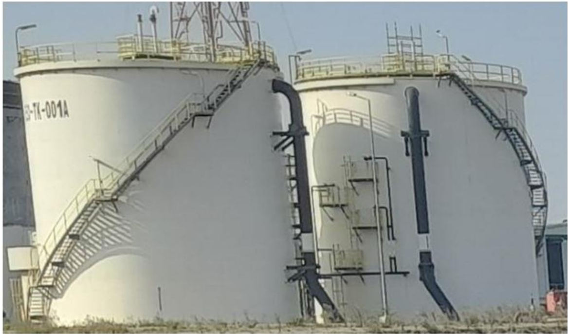
Bac des eaux pluviales 850-TK-001 A & B
