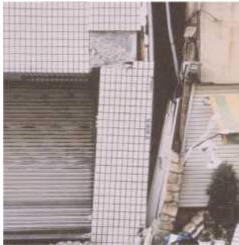
Figure 2.18. Dommages dus à l'entrechoquement de bâtiments voisins (séisme de Kobé, Japon, 17 janvier 1995)
