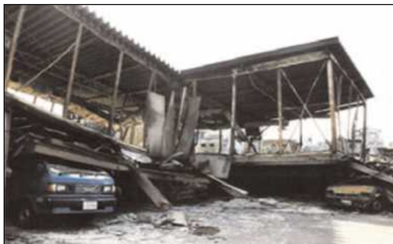
Figure 2.11. Effondrement d'un bâtiment dont le rez-de-chaussée n'était pas suffisamment contreventé (séisme de Kobe, Japon, 17 janvier 1995)
