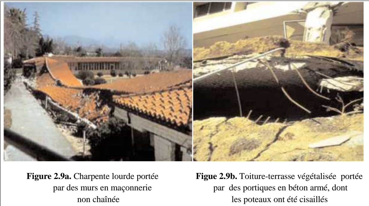
Figure 2.9. Effondrement d'ouvrages supportant une toiture lourde (séisme de San Fernando, Californie, 9 février 1971)
