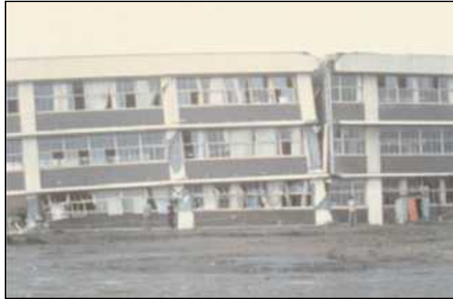
Figure 2.14. Dommages dus à l'entrechoquement de deux blocs des bâtiments séparés par un joint de dilatation thermique (séisme de Tokachi-Oki, Japon, 16 mai 1968)
