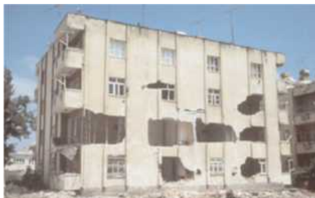
Figure 2.19. Bâtiment endommagé lors de l'effondrement d'une construction voisine (déblayée avant la photo), séisme de Ceyhan-Misis, Turquie, 27 juin 1995
