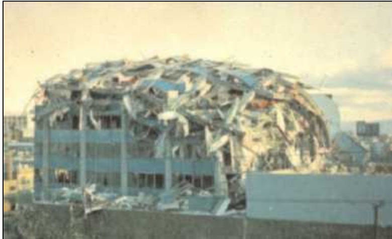
Figure 2.17. Dommages dus à la résonance du bâtiment avec le sol (Mexico, séisme du Mexique, 19 septembre 1985)
