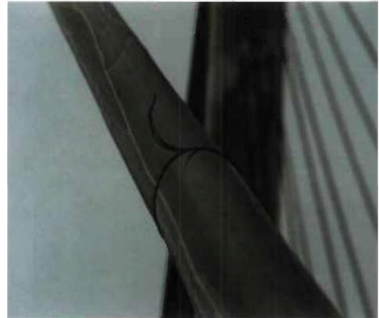
Figure 2-7 : Rupture de gaine PEHD de type ESC
