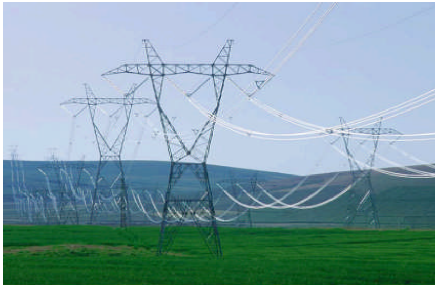
Figure 1-6: Photo de ligne de transport d'énergie électrique
