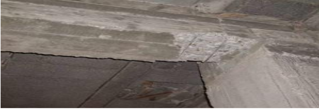
Figure I.8 : Fissuration par cisaillement dans la poutre (Séisme de Boumerdes, Algérie, 2003). [9]
