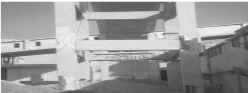
Figure.I.22 : Endommagement d'un nœud poteau-poutre par cisaillement (Kobe, Japon, 1995).
