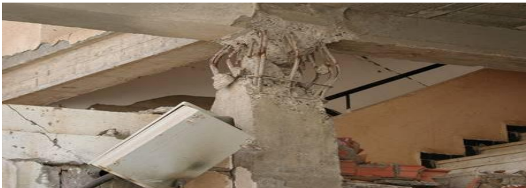
Figure I.14 : Flambement des barres et rupture par cisaillement d'un poteau en béton armé (Séisme de Boumerdes, Algérie -2003).
