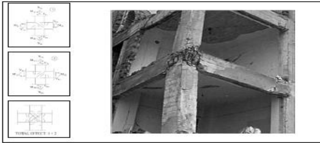
Figure I.17 : Types de dommages sismiques des assemblages poteaux-poutres intérieurs.
