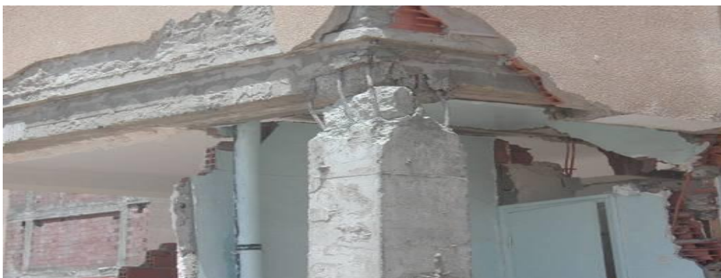
Figure I.19 : Ruine d'un nœud d'un poteau d'angle (Séisme de Boumerdes, Algérie, 2003).
