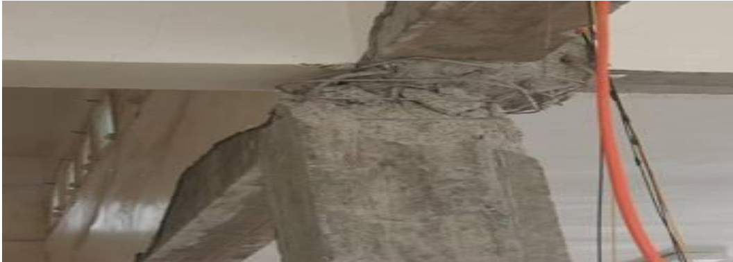
Figure.I.13 : Ruine d'un poteau court (Séisme de Boumerdes, Algérie ,2003).
