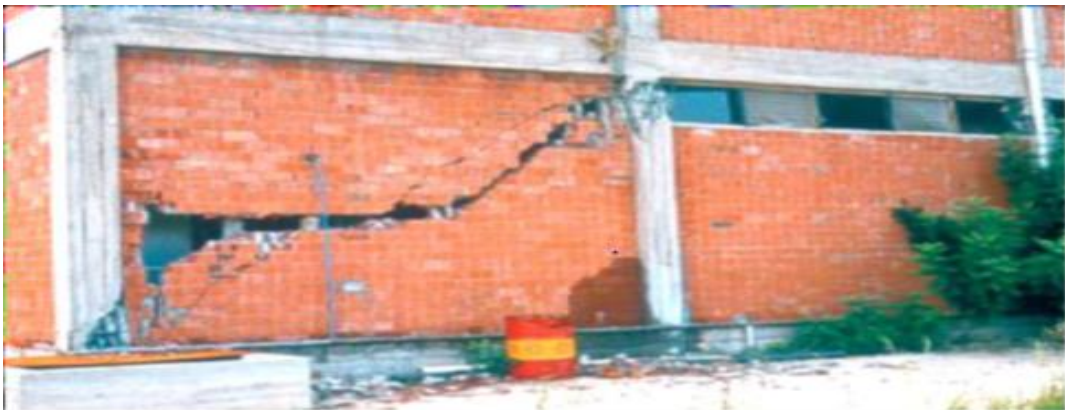
Figure I.5 : Endommagement de remplissage causant le cisaillement des poteaux. [5]
