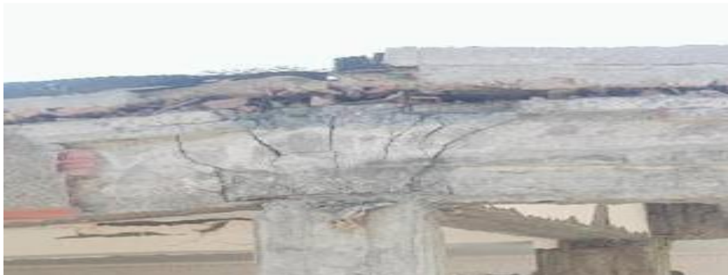
Figure I.9 : Rupture par cisaillement d'un nœud en béton armé (Séisme de Boumerdes, Algérie, 2003). [9]
