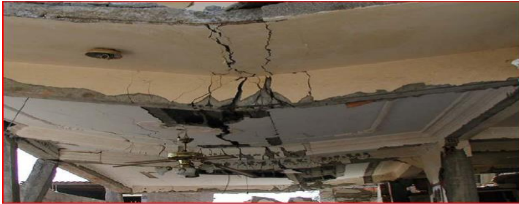
Figure.I.6 : Fissuration par flexion dans la travée des poutres (Séisme de Boumerdes, Algérie, 2003). [5]
