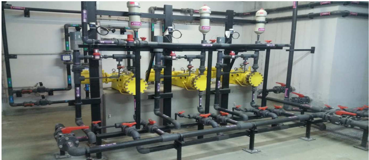
Figure II.3 Modèle d'installation des pompes doseuses.
