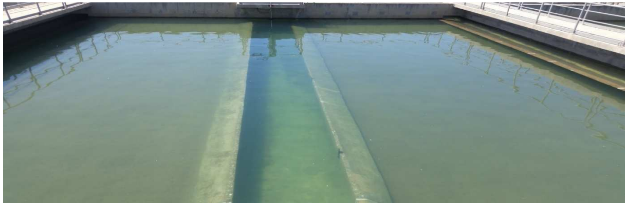
Figure I.11 : Filtres à sable
