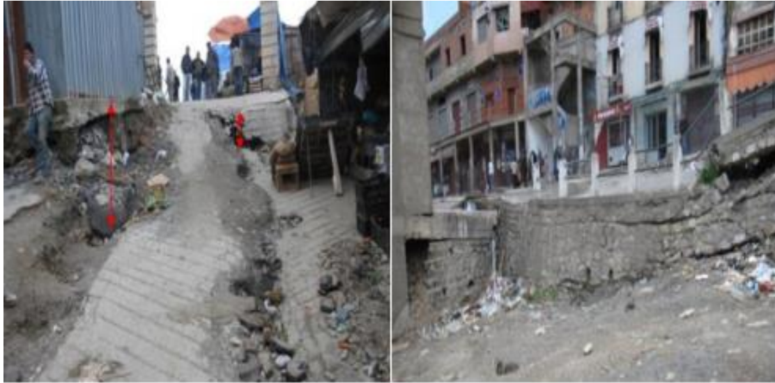
Figure V.3. Les désordres aux niveaux du glissement d'Ain El Hammam (Bouaziz et Melbouci., 2015).
