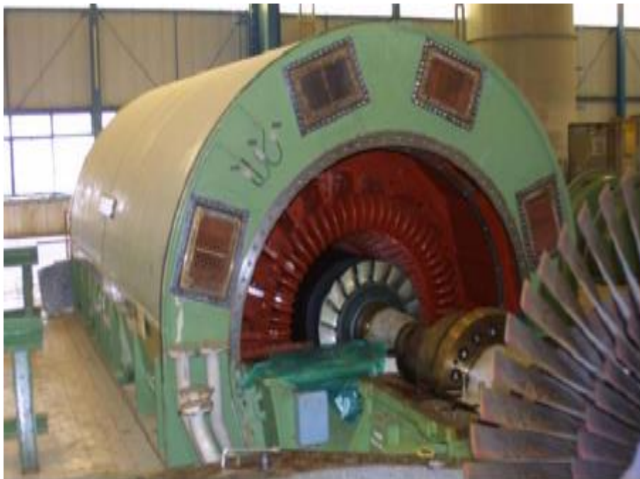
Figure I.8 : Vue réelle d'un Alternateur de la centrale.
