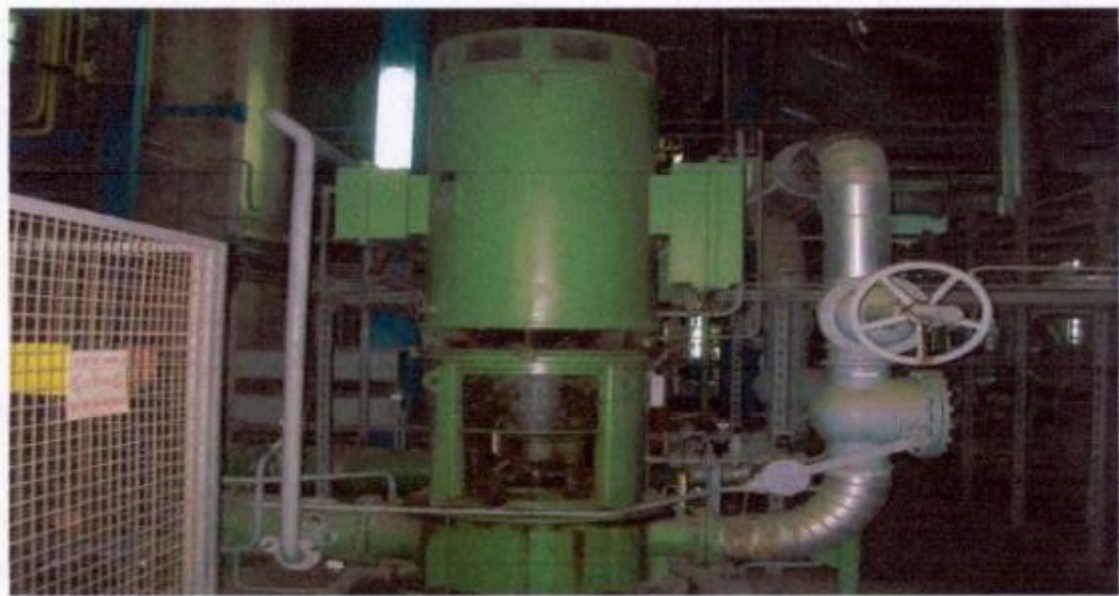
Figure 1.4 : Vue de face de la pompe d'extraction.
