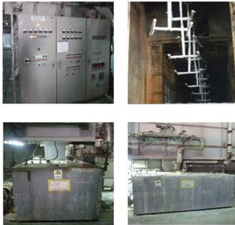
Fig. IV.16 : Tunnel de prétraitement TOSHIBA utilisé.
