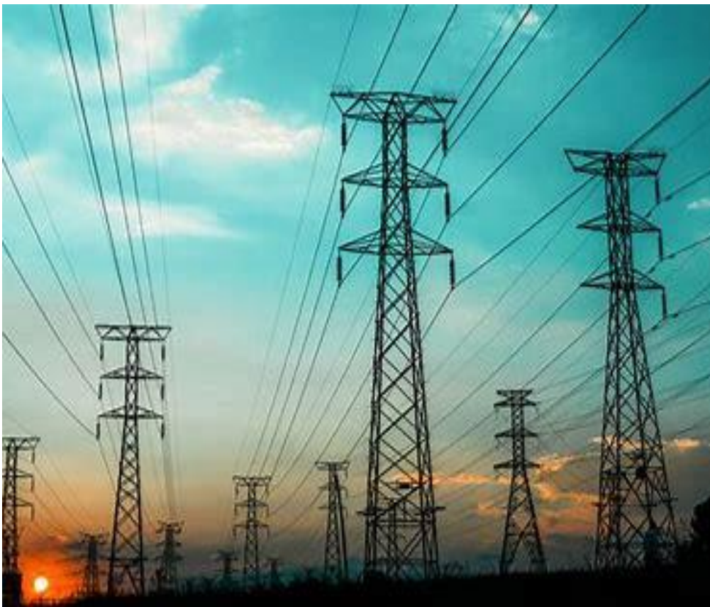
Figure I.1 : Ligne de transport haute tension
