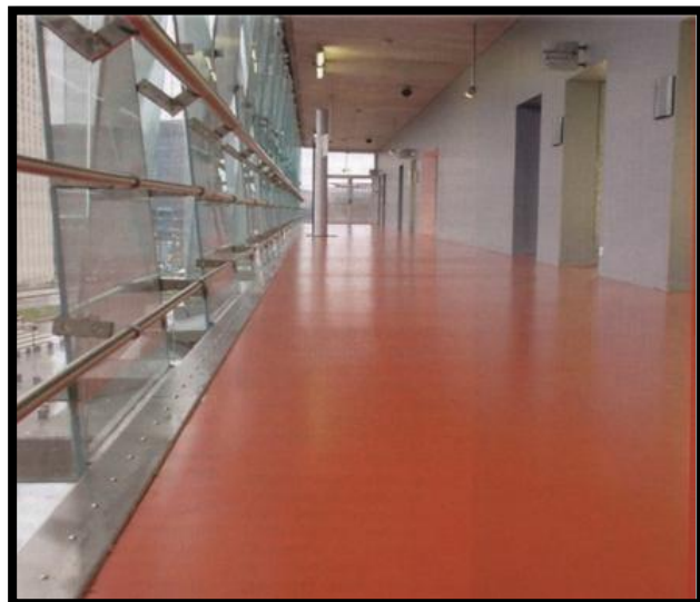
Revêtement du sol en PVC
