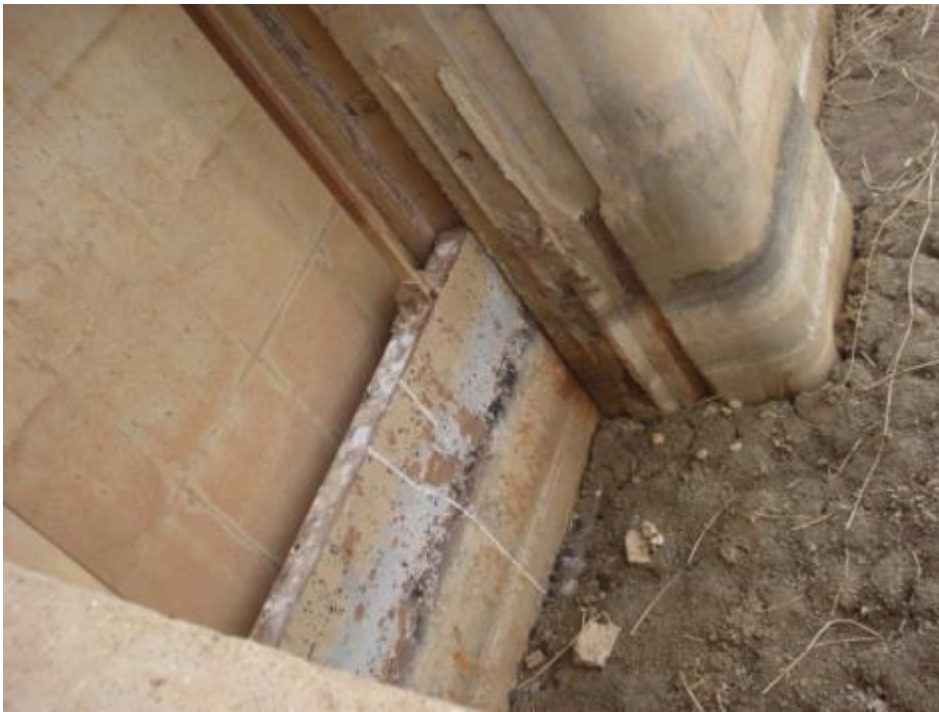
Figure 1.12: Blocage de la vanne de fond
