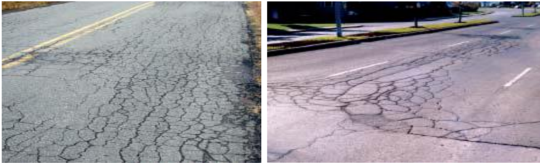
Figure I.31 : Fissures en carrelage.
