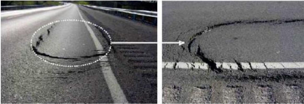
Figure VI.2 : Exemple de dégradation par cisaillement d'une chaussée (zone de freinage-accelération).
