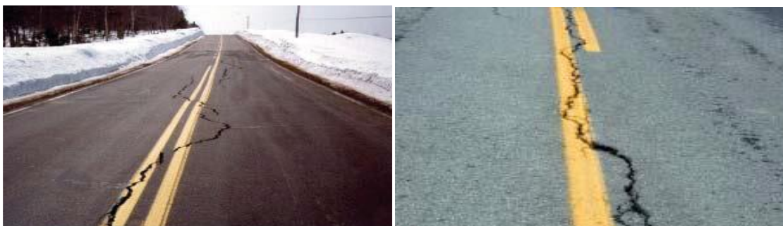
Figure I.32 : fissures de gel
