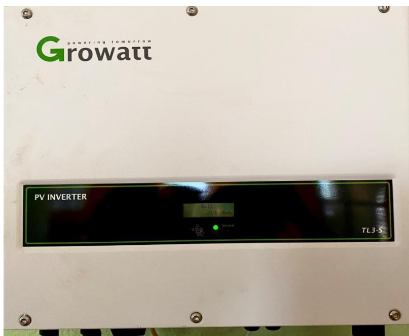
Figure 2.13 : Un onduleur réseau
