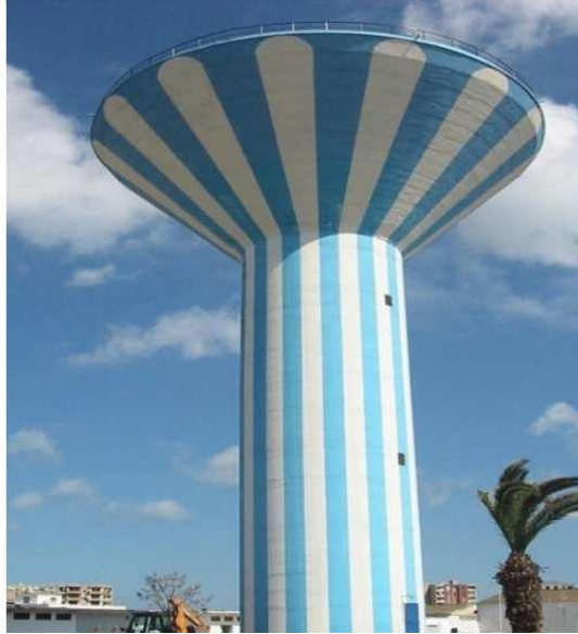
Figure 4.4. Réservoir à pendule inverse
