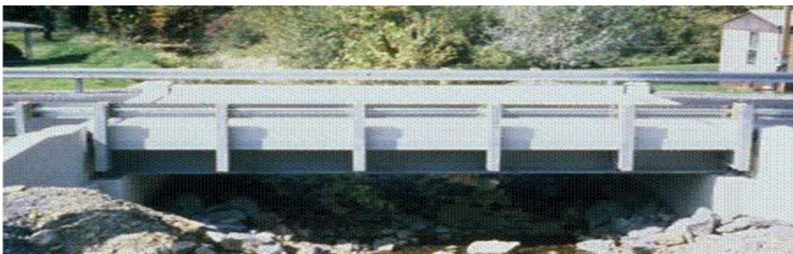
Figure I.24 : Pont routier de petite portée entièrement fait de PRF [16].
