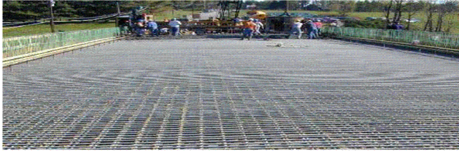
Figure I.22 : Barres d'armatures en PRF de verre placées dans un tablier de pont en béton avant la mise en place du béton [17].
