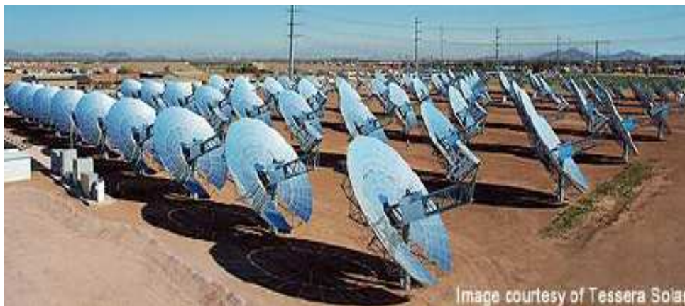
Figure II.4 : Vue de la centrale Maricopa (source : Tesseract Solar)
