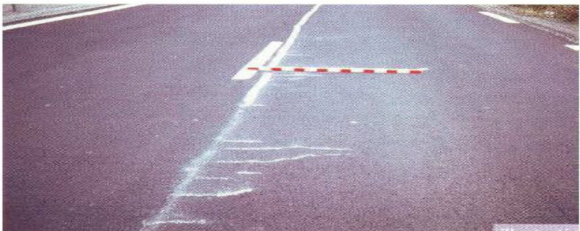
Fig I.22 : Remonté des fines : dégradation franche, significative et étendue (LCPC, 1998).
