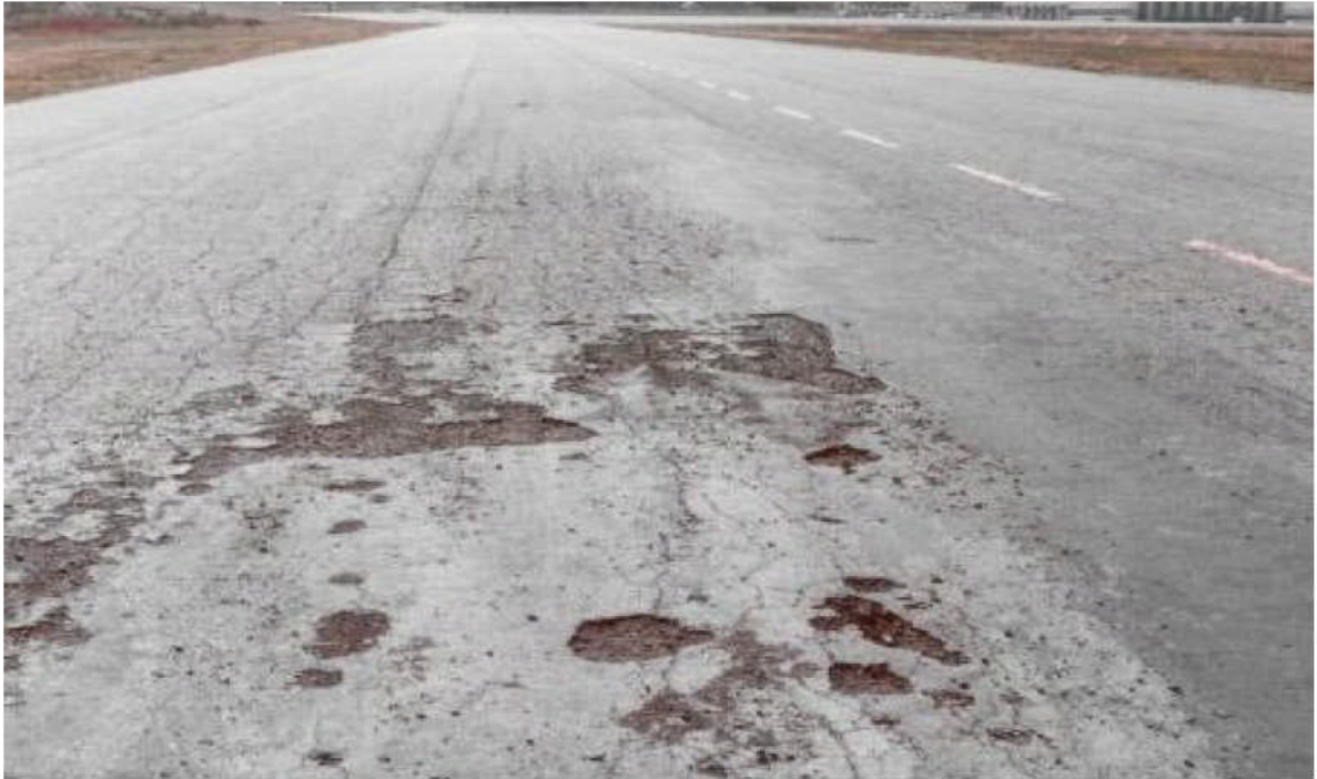
Fig I. 21 : Dégradation d'arrachement (LCPC, 1998).
