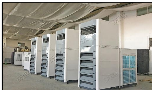
Figure 258 : centrale de climatisation Source : www.climamaison.com
