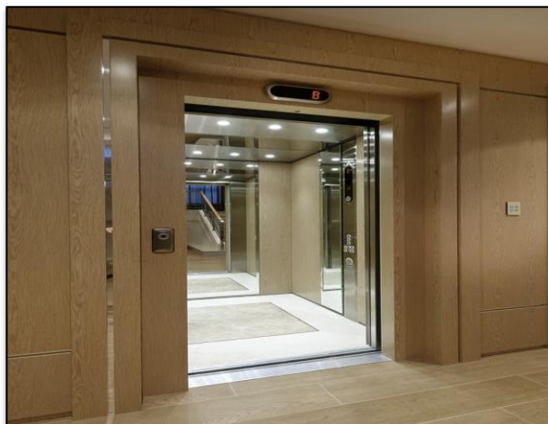
Figure 256 : Exemple d'un ascenseur Source : Google image
