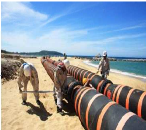
Transfert des hydrocarbures
